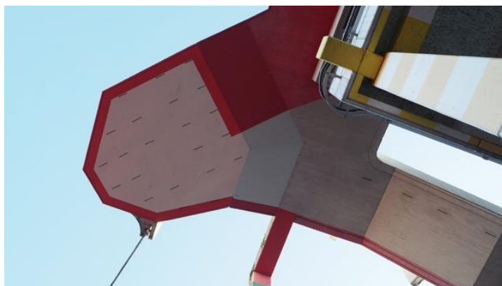
Abbildung 3 Kunst am Bau an der Universität Konstanz von Bernd Hanewinkel, „o.T.“, 1970-72, Dispersionsfarbe auf Beton. ©Denise Madsack.
